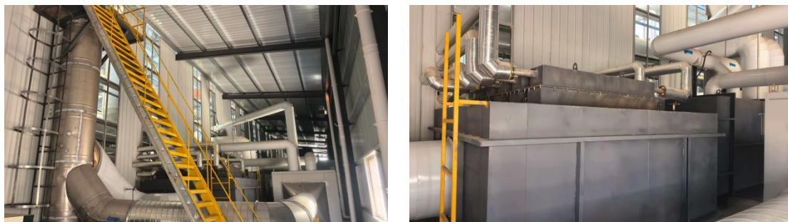
图 4.3-1 废气处理设施
